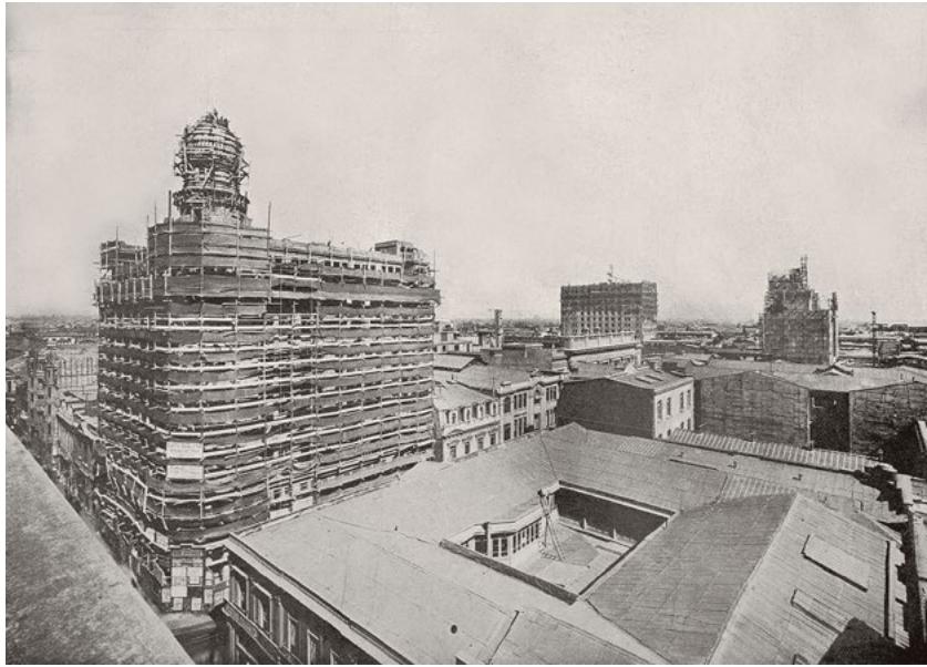
figura 1 Construcción del Edificio de Seguros La Sudamérica, Bandera con Agustinas, Santiago. Fuente: Arquitectura y arte decorativo: año 1, número 11, julio 1930. Disponible en Memoria Chilena, Biblioteca Nacional de Chile https://www.memoriachilena.gob.cl/602/w3-article-318086.html . Accedido en 28/3/2024.
