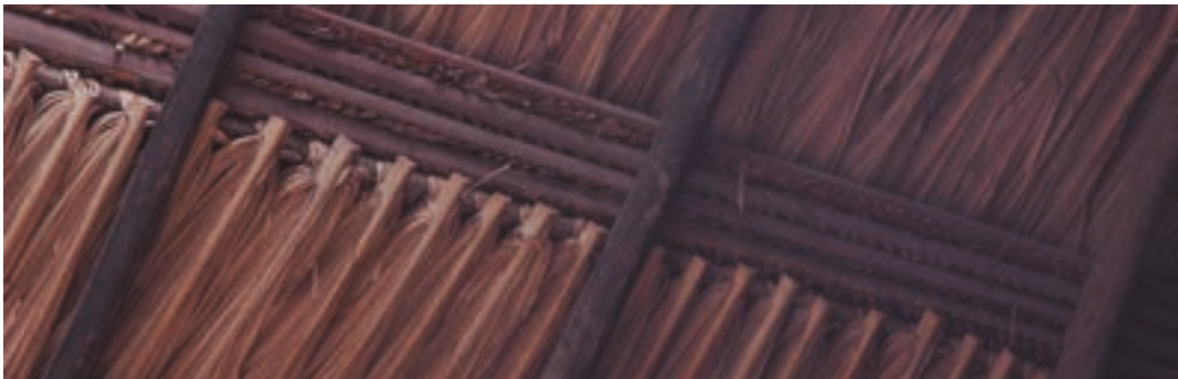
Estructura de cubierta en madera. Reserva Natural El Matuv, corregimiento de Palomino, La Guajira, Colombia. Fotografía: Martin Olga Valderrama - AGRA
