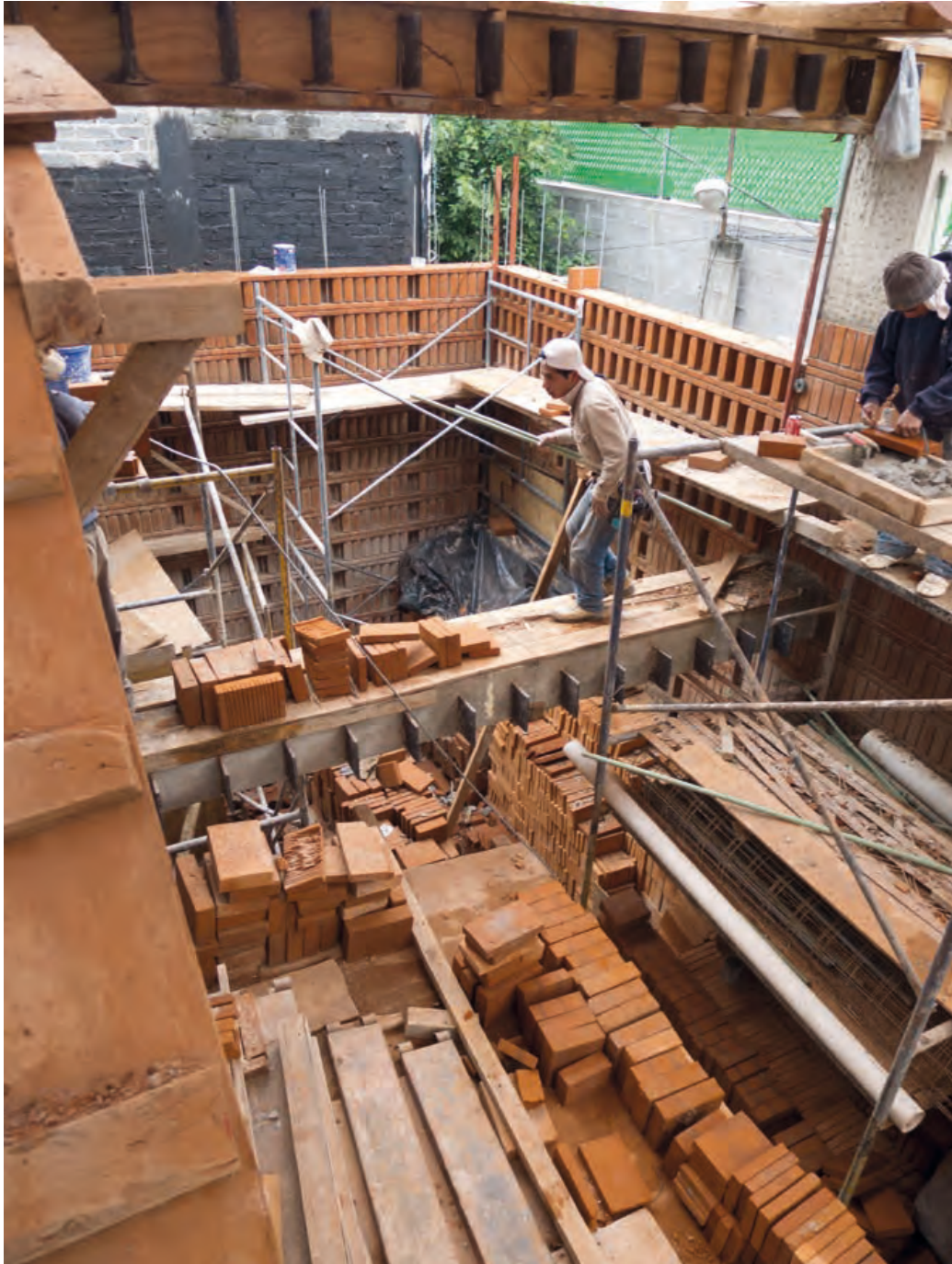
Proceso de construcción y aparejo de los muros del Estudio Iturbide donde se puede apreciar la varilla en espera que arma verticalmente el lienzo.
