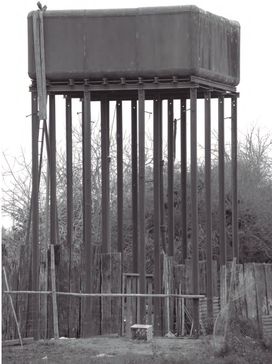
Torre de agua de hierro y rieles de tren. Alcones, Marchigüe, VI Región, Chile. Fotografía: Camilo Palma
